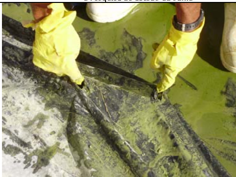
Figura 15: Lona plástica impermeabilizante danificada por ações não identificadas de vandalismo
