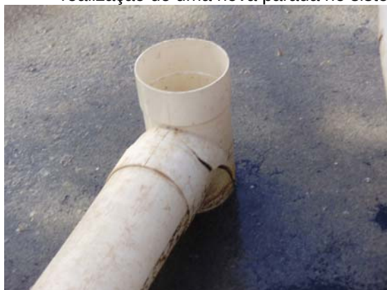
Figura 11: Rachadura na tubulação
