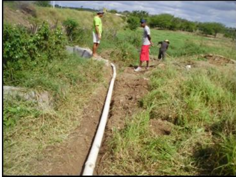
Figura 23 – Tubulação de drenagem do poço de sucção, observando-se que a ponta da tubulação está a jusante da barragem de nível.
