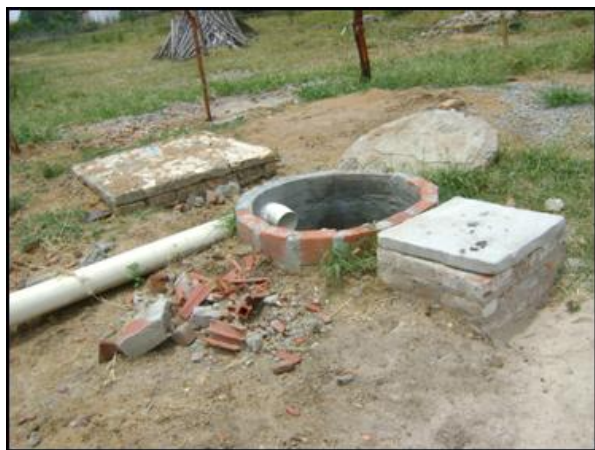
Figura 20 – Poço de sucção, observando-se no detalhe o poço onde está instalada a bomba.
