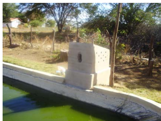
Figura 14: nova casa de bomba
