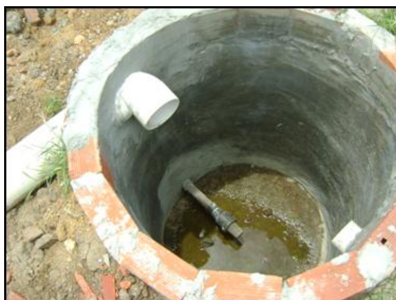
Figura 21 – Interior do poço de sucção, observando-se à esquerda a tubulação de chegada no poço, ao centro, embaixo, a tubulação de sucção da bomba e à direita a saída da drenagem do poço.
