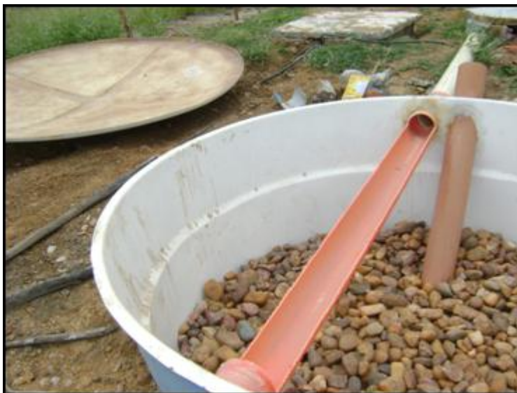
Figura 19 - Interior do filtro anaeróbio.
