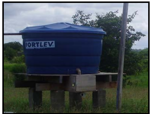
Figura 12 – Tanque de Equalização.
