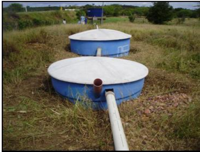
Figura 15 – Módulo de tratamento, observando-se ao fundo o tanque de equalização.
